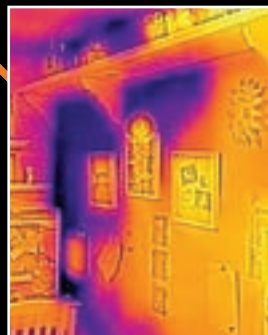
Braki w izolacji
