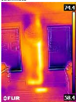
Wykrywanie gorącej rury ściekowej w ścianie
