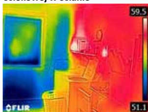
Nieizolowana ściana nośna
