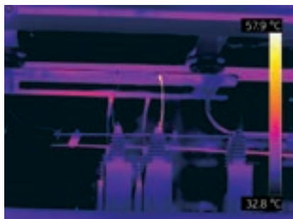
Gorący przewód zasilania transformatora
