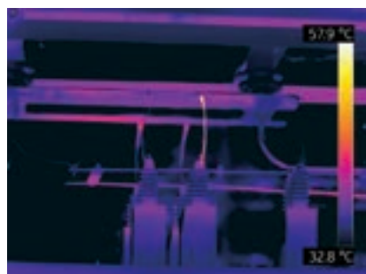
Gorący przewód zasilania transformatora
