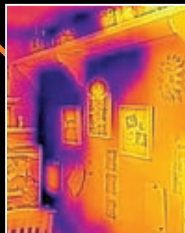
Braki w izolacji
